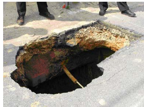
Un effondrement rue de Pailly.
